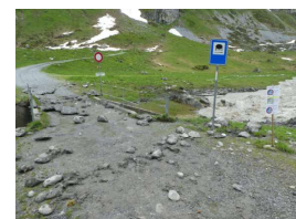
Ablagerungen auf der Brücke weisen darauf hin, dass diese zeitweise durch den Fätschbach überströmt wurde.
