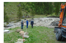
Sowohl eine Brunnstube als auch die Wasserleitung der öffentlichen Wasserversorgung Urnerboden wurden beinahe zerstört.
