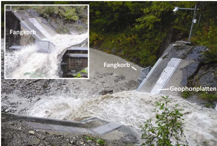
Abbildung 3: An der Wildbachsperre beim Einlauf in den Geschiebesammler sind unter den Stahlplatten Geophonsensoren montiert. Seit 1986 wird damit kontinuierlich die Intensität des Geschiebetransportes erfasst (eine weltweit einmalige Datenreihe). Mit der neuen Fangkorbmessanlage können u.a. die Geophonmessungen besser geeicht werden.
