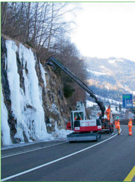
Abbildung 1: Entfernen von absturzgefährdetem Eis. Foto: Betrieb GE1, Winter 2012/2013
