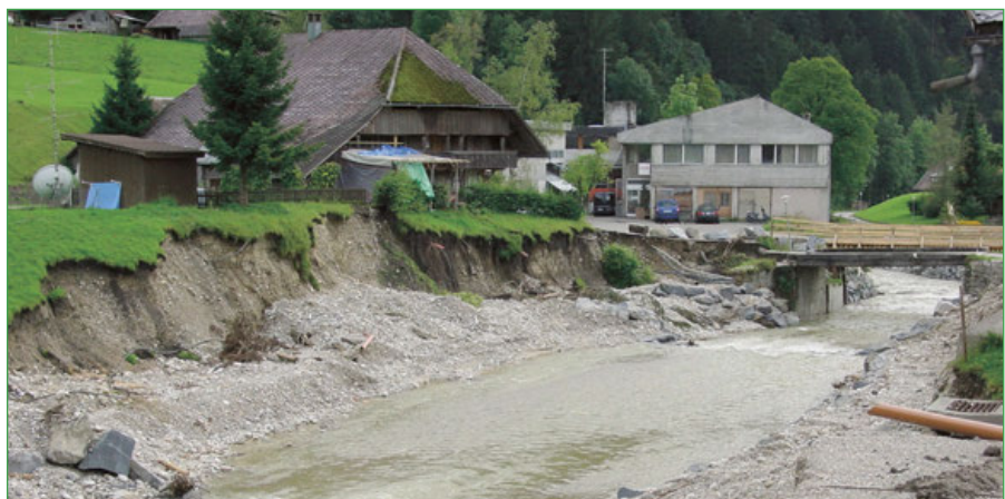
Abbildung 1: Ufererosion an der Trueb beim Hochwasser 2005. Foto: Flussbau AG SAH.
