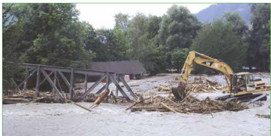
Abbildung 1: Verklausung an der Eisenbahnbrücke in Sarnen während des August Hochwassers 2005 (Quelle: Tiefbauamt Kanton Obwalden).
