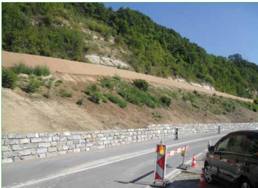
Figure 6 : Digue de protection réalisée à la place des maisons. Photo : S. Lévy, DGE, 2015
