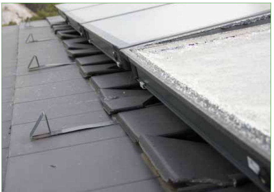
Abbildung 4: Schneedruck beschädigte nicht nur die Solarmodule, sondern auch die Dacheindeckung (Bildquelle: Gebäudeversicherung Graubünden).
