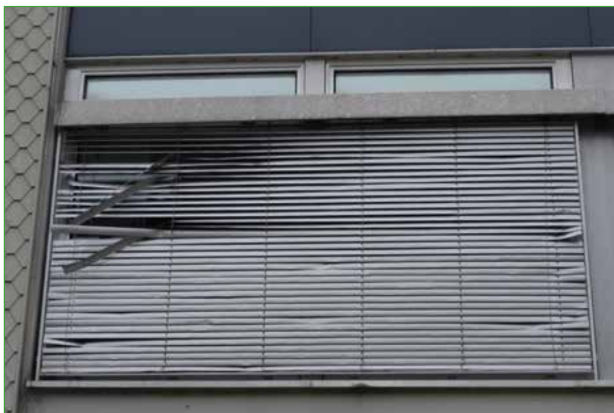
Abbildung 5: Die Kombination von Hagel und Sturm übersteht keine Lamellenstore - ausser, wenn sie rechtzeitig hochgezogen wurde (Bildquelle: VKF).
