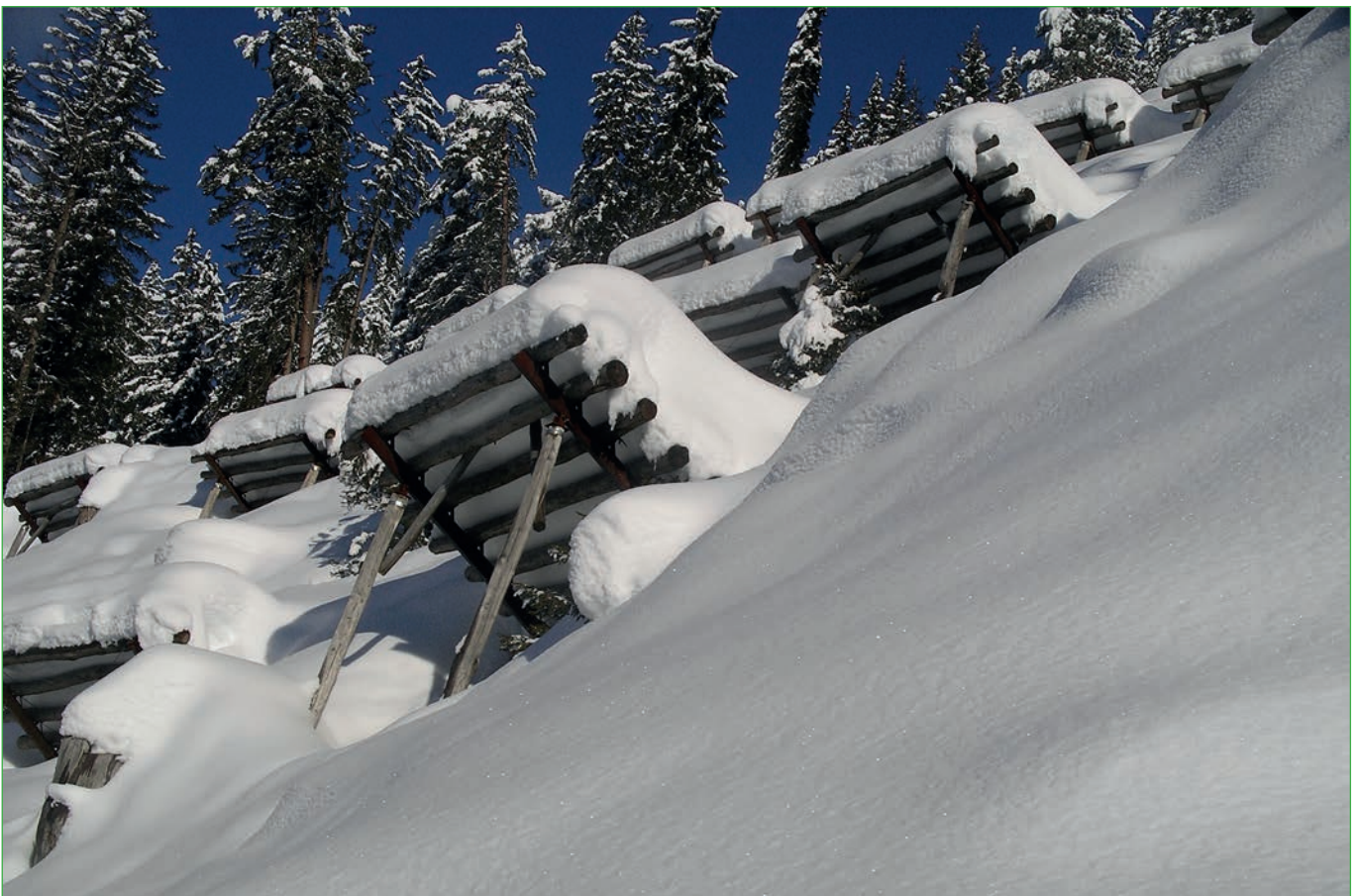
Abbildung 2: Temporäre Stützverbauungen aus einer Holz-Metall-Kombination (System rempar grischun) überbrücken die Schutzwirkung, bis sich der Schutzwald wieder erholt hat (Foto: Crestageo AG).
