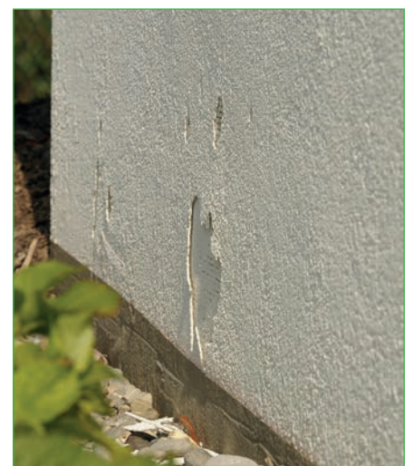
Abbildung 1: Hagelschaden an Verputz (Quelle: VKF)
