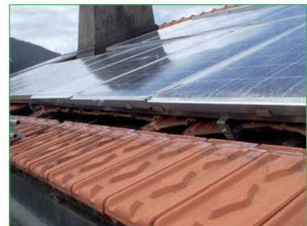
Abbildung 3: Schaden an der Dacheindeckung infolge zu hoher Punktlasten (Quelle: GVG)
