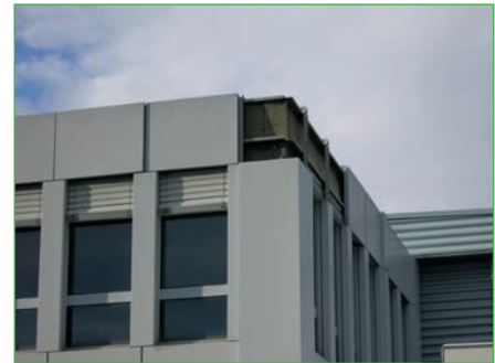
Abbildung 2: Durch Sturm abgelöste Fassadenelemente (Quelle: GVG)
