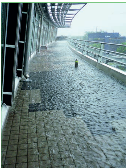
Abbildung 4: Geringe Mengen Wasser an einer kritischen Stelle reichen für einen grossen Schaden (Quelle: VLF)
