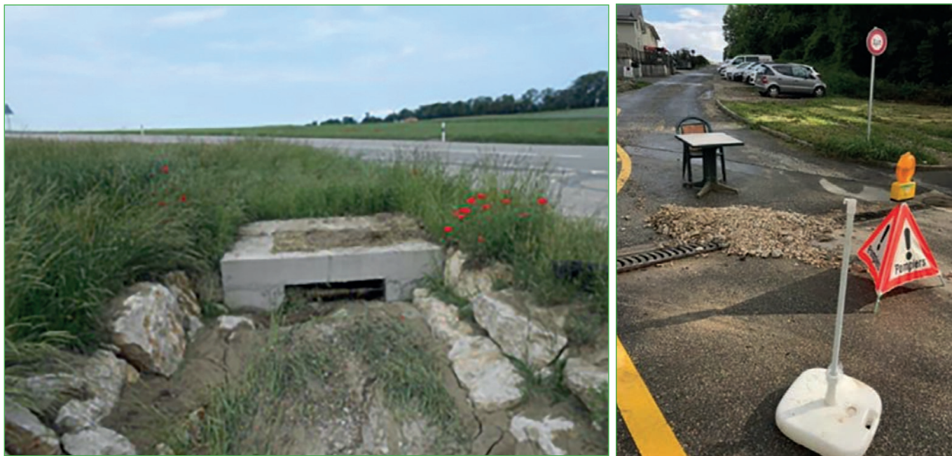
Figure 3 : Ouvrages bouchés lors de l'événement du 31 mai 2018 à Yverdon
