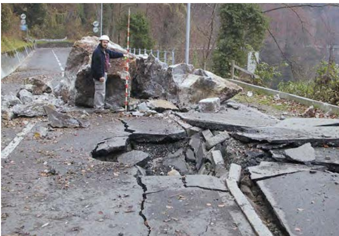
Abbildung 1: Schäden auf der Kantonsstrasse von Vitznau LU Richtung Gersau SZ.
