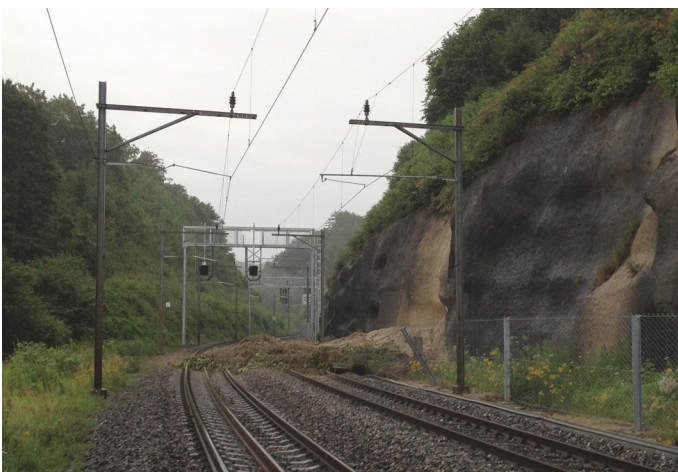
Abbildung 1: Starkniederschläge und Vegetationsveränderungen können vermehrt Böschungen destabilisieren (SBB).
