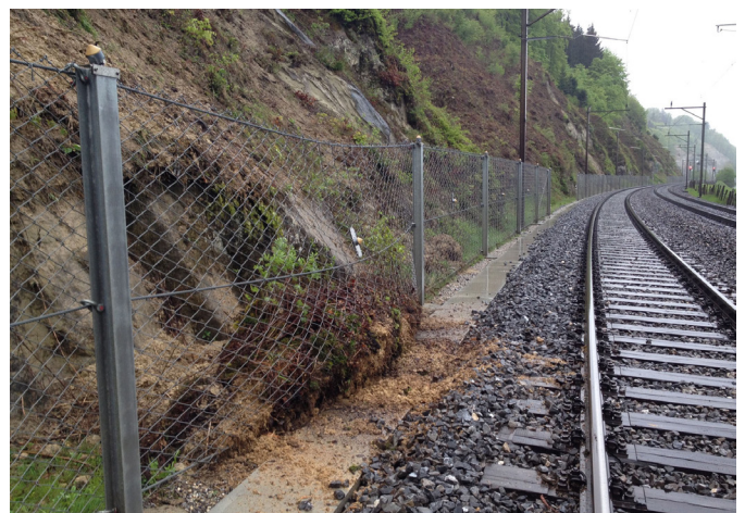
Abbildung 2: Schutzbauten, Alarmanlagen und Überwachung müssen neu gebaut oder abgepasst werden (SBB).
