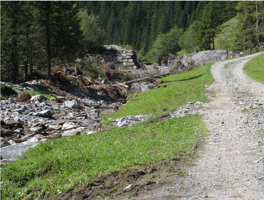
Abbildung 4: Kollaps der Sperre im Rezliberg (M. Zimmermann).
