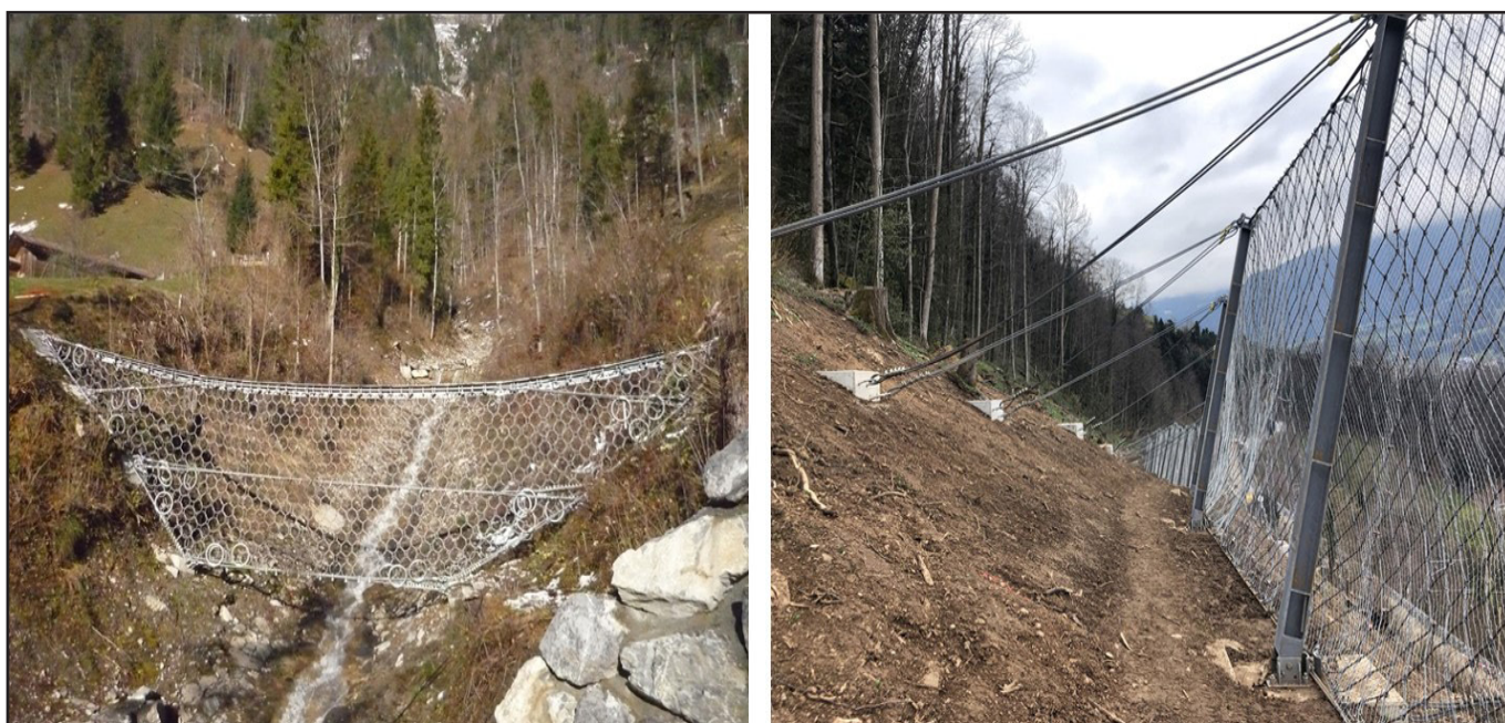
Abbildung 1: Murgangschutznetz im Trachtbach (links, Quelle: Geobruigg AG) und Hangmurenschutznetz am Baltisberg (rechts, Quelle: Pfeifer-Isofer AG).
